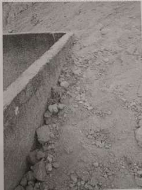
Montante de terra pressionando o muro do condomínio
