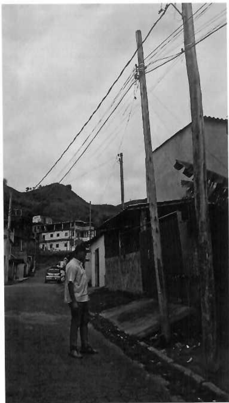
POSTE COM RISCO DE QUEDA RUA SUCUPIRA, EM FRENTE AO Nº 33, BAIRRO SÃO JOÃO.
